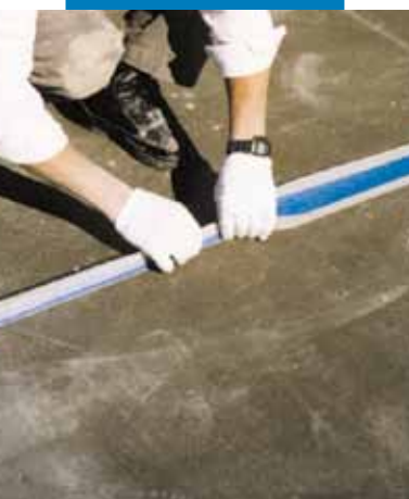
Un exemplu de impermeabilizare elastică a rosturilor de dilatare la o terasă
