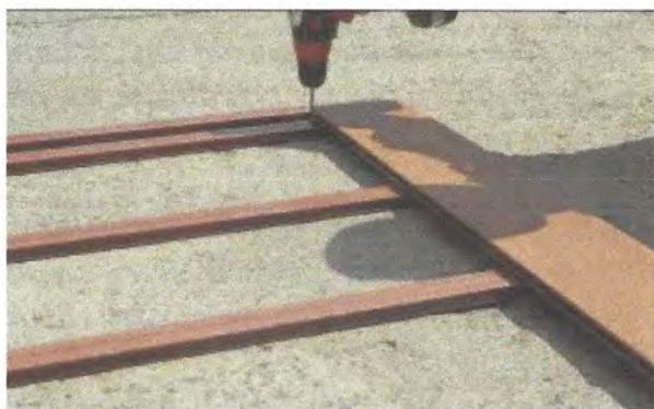
Fig. 2. Poziționarea șinelor suport tip WPC și fixarea provizorie la unul din capete
