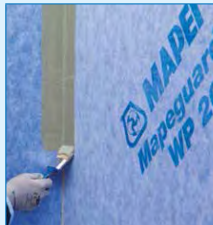
Aplicarea MAPEGUARD WP ADHESIVE pe imbinarea dintre fasile de membrane la pereti pentru sigilare cu MAPEGUARD ST
